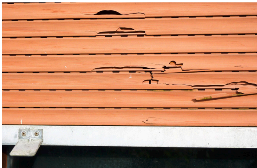
Beschädigter Rollladen aus Kunststoff nach Hagelschlag
