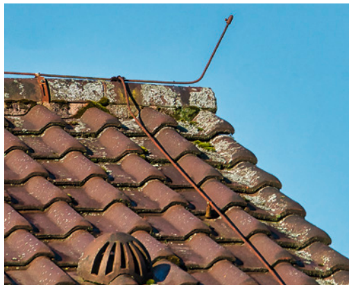
Fangeinrichtung einer Blitzschutzanlage
