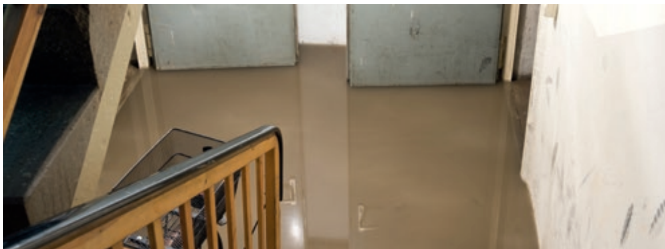
37 Kellerüberflutung nach Rückstau
