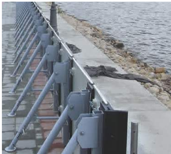
Hochwasserschutz mit Hochwasserschutzplatten aus Kunststoff
