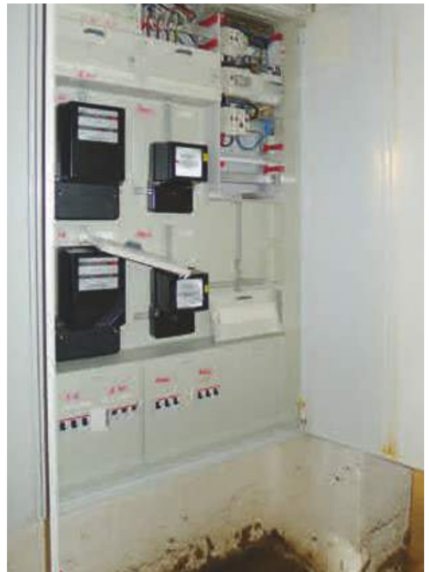
Überfluteter Sicherungsasten in einer Erdgeschosswohnung
