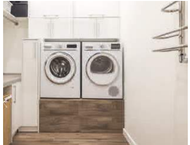
Waschmaschine und Trockner auf einem Podest
