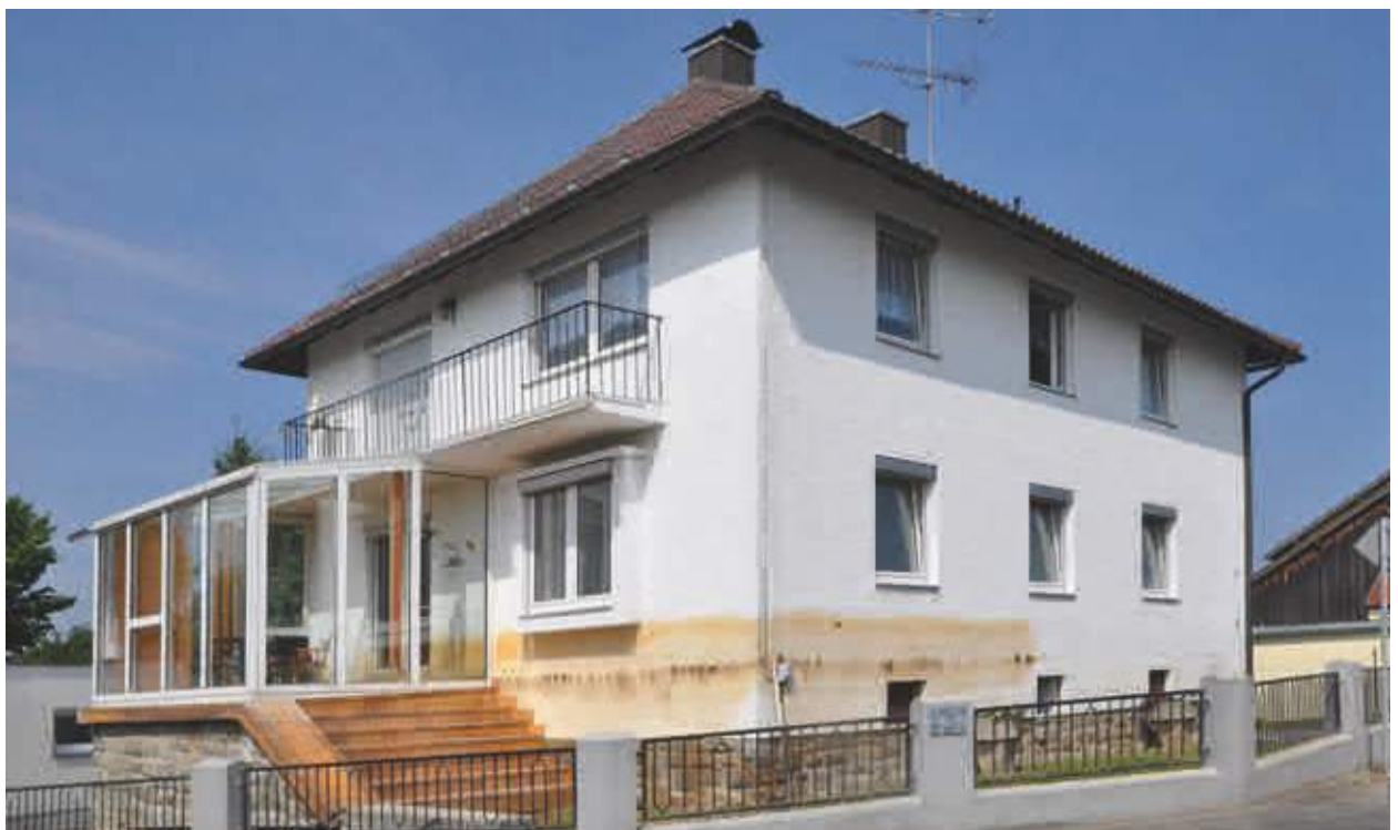
Mit Heizöl belastetes Wärmedämm-Verbundsystem eines Wohnhauses
