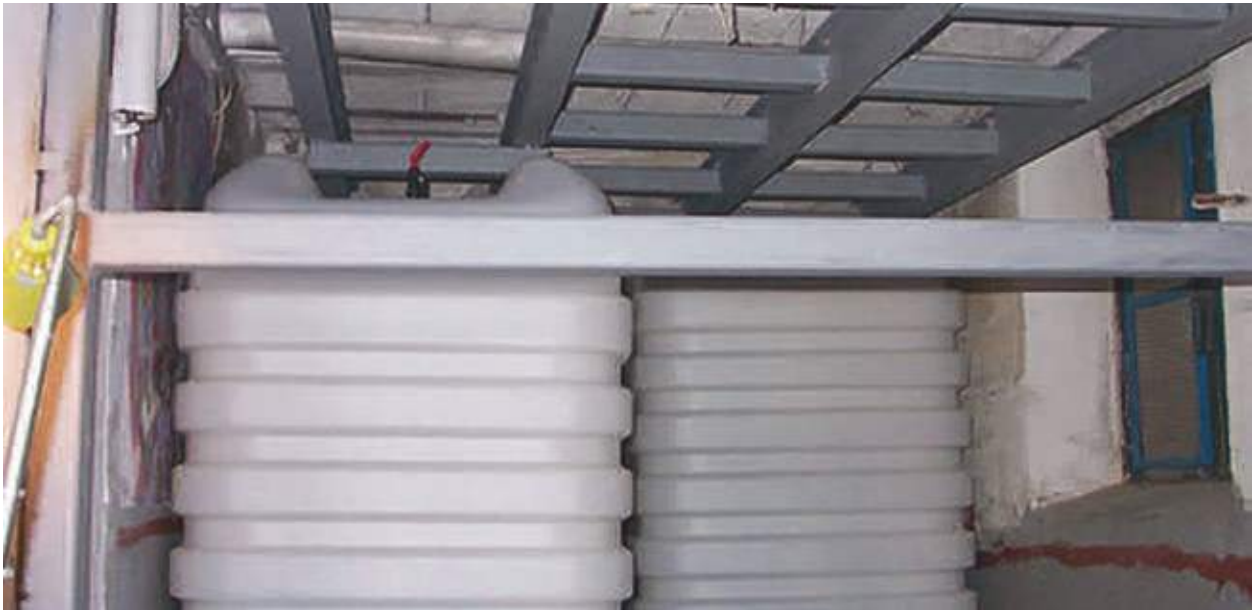
Heizöltankanlage mit Auftriebssicherung
