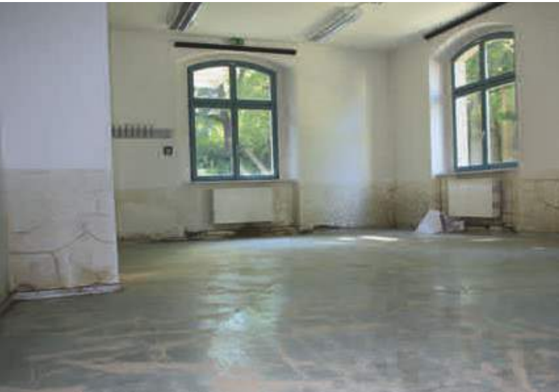
Durchfeuchtete und verschmutzte Außenwände nach Überflutung
