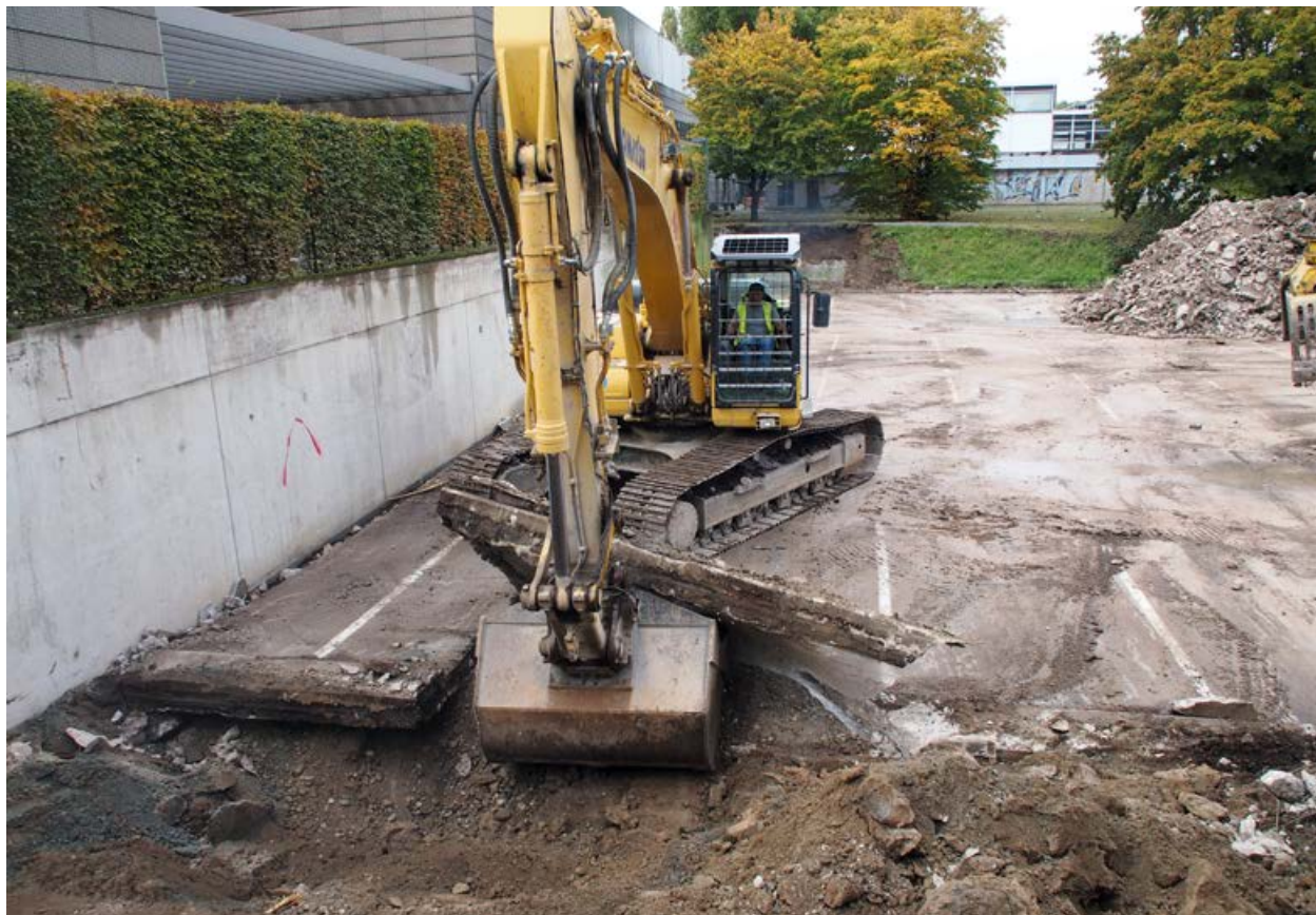
Untersuchungsobjekt 1 – Reißen der Bodenplatte
