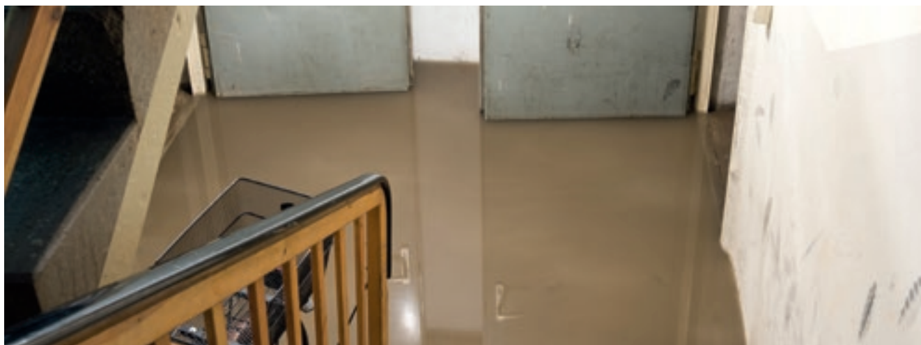
37 Kellerüberflutung nach Rückstau
